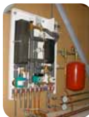
Echangeur chez l'habitant Plus de chaudière Plus de citerne à mazout
